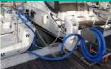
Equipement d'aspiration des eaux noires © internet
